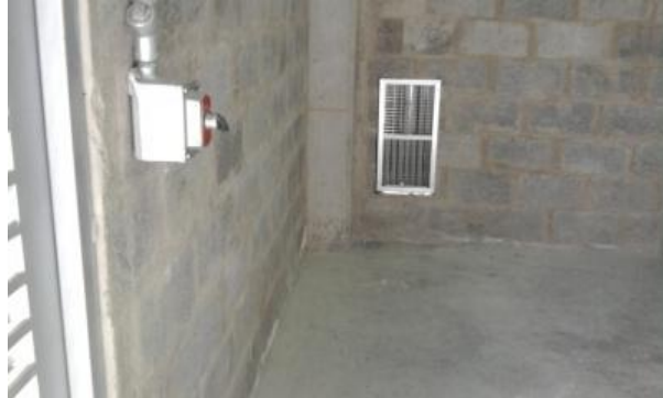
Imagen 16. Ductos de ventilación de las instalaciones del centro de acopio de residuos peligrosos.
