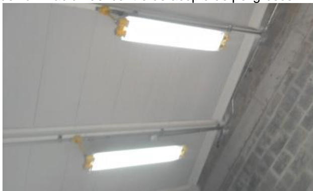
Imagen 18. Bombillas de iluminación del centro de acopio de peligrosos.
