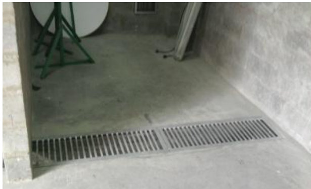
Imagen 17. Rejillas de drenaje de líquidos hacia el alcantarillado.
