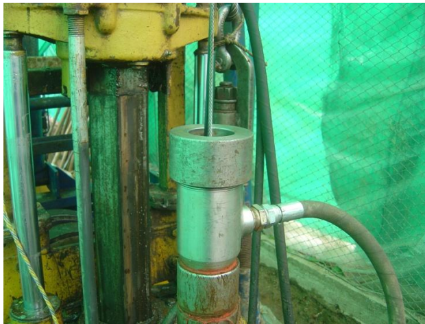
Figura 4. Sistema de Inyección de agua al pozo.
