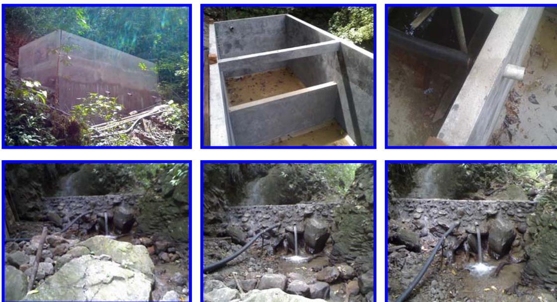
Figura 5. Tanque de almacenamiento de agua y red de distribución. Vereda de Bocas
