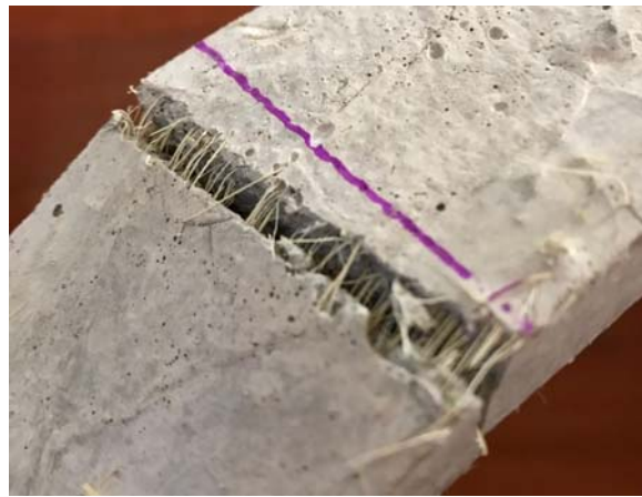
Imagen 27 - fisura expuesta a exceso de carga
