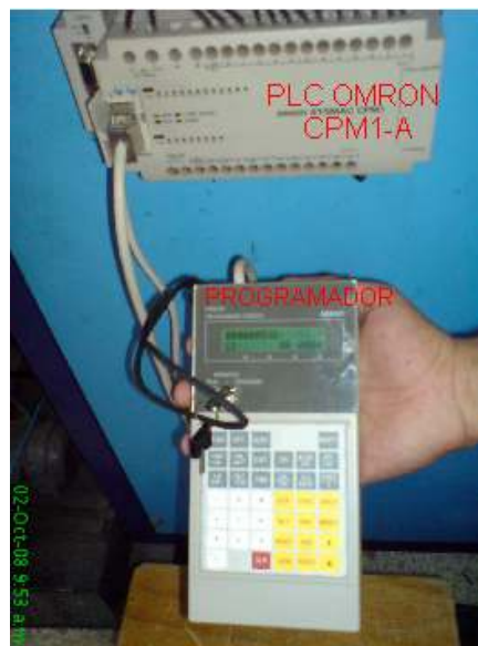
Figura 37. Programador del PLC.
