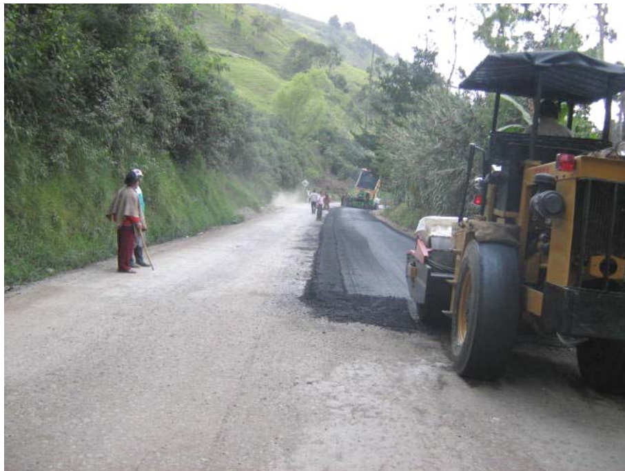
Conformación de la capa asfáltica con MDC-2 en el tramo comprendido entre el PR73+250 y el PR74+504.
