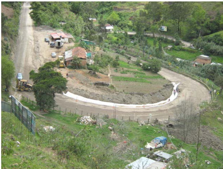
Construcción de filtro con geotextil en la parte interna de la curva ampliada en el PR73+000.
