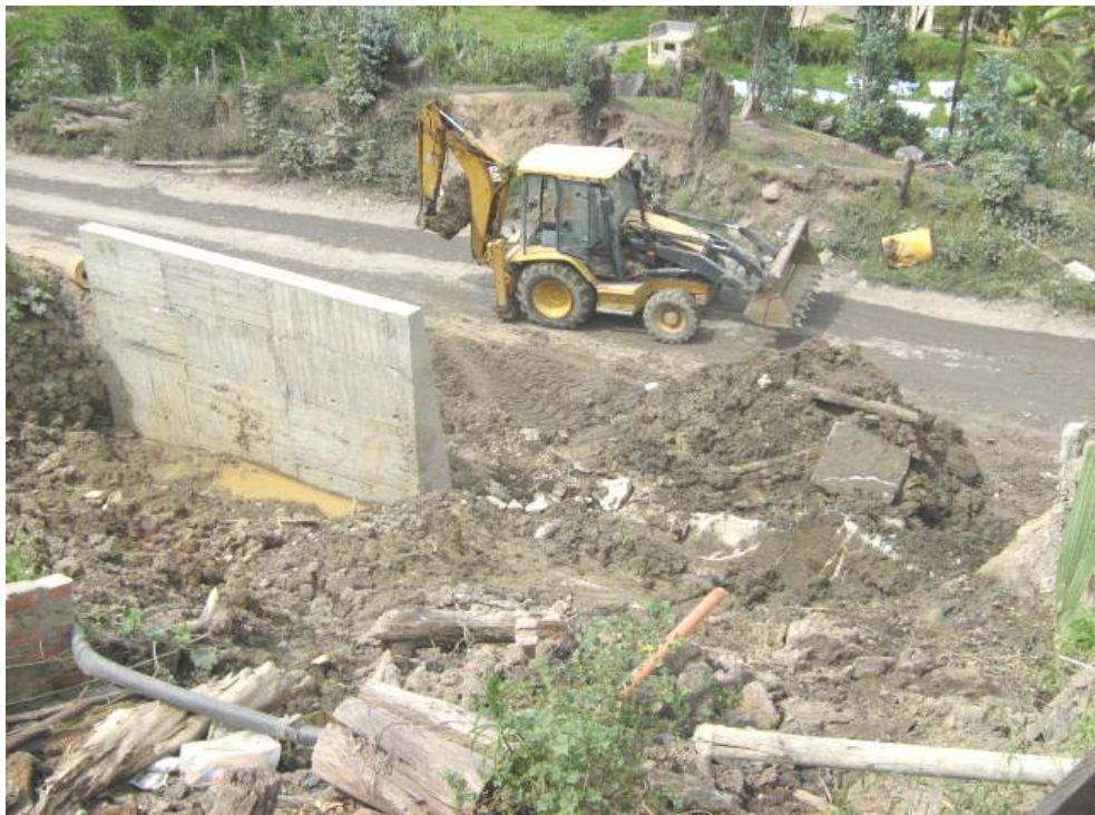
Excavación mecánica para la construcción del nuevo muro en concreto clase C (4000 PSI) en el PR73+000.
