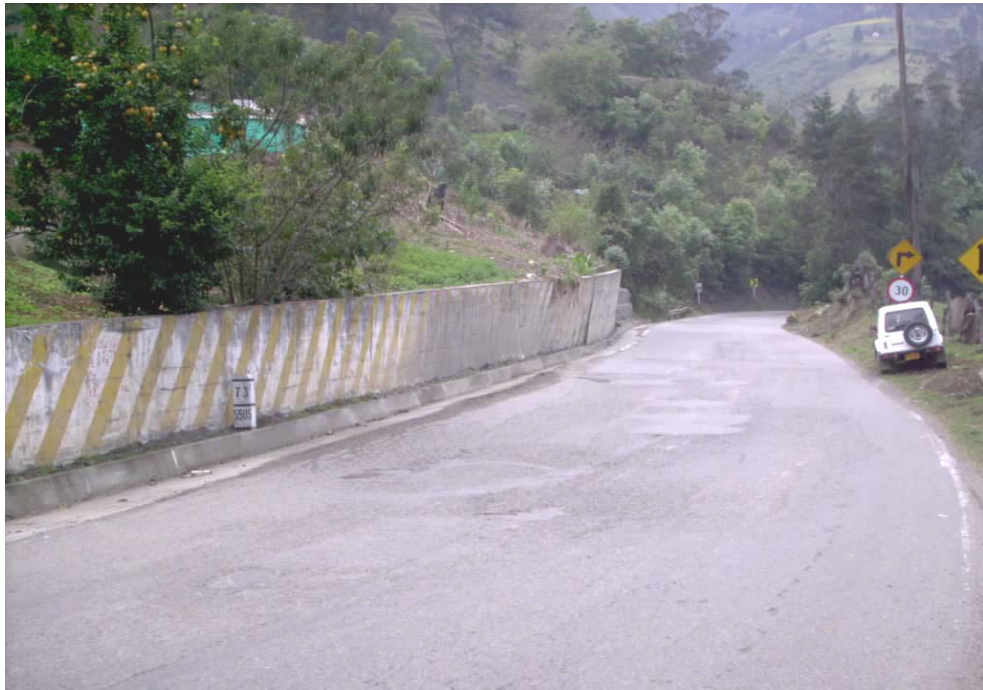
Vista general del muro en el PR73+000 que ha fallado por volcamiento.
