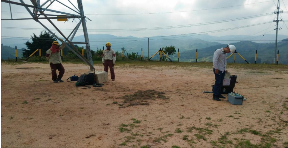
Figura 50. Medición tensión de paso y contacto
