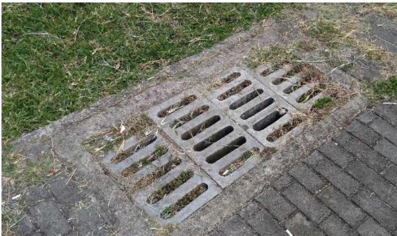
Desagüe piso. Hecho en concreto con estructura de varilla de hierro. Césped y residuos naturales tapan gran parte del drenaje.
