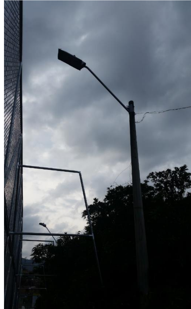
Luminaria urbana. Base de concreto, varillas de hierro y bombillo de alto alcance. Ubicada en cancha de fútbol.
