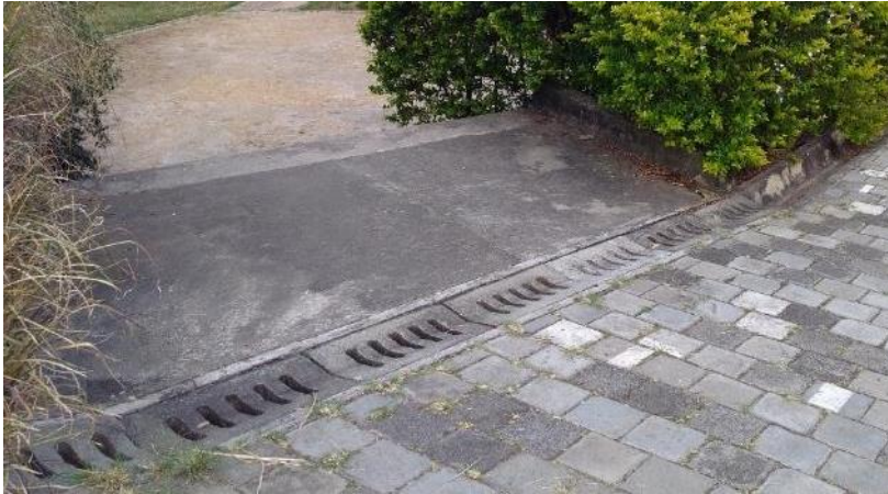
Desagüe tipo V. Hecho en concreto, tiene forma en V para facilitar la caída del agua. Ubicado en la entrada del auditorio al aire libre.
