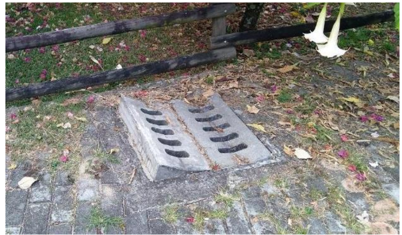
Desagüe tipo v. Hecho en concreto. Ubicado en una zona plana, cerca de una ladera verde. Uno de los elementos de desagüe esta levantado, esto evidencia deterioro y falta de mantenimiento.
