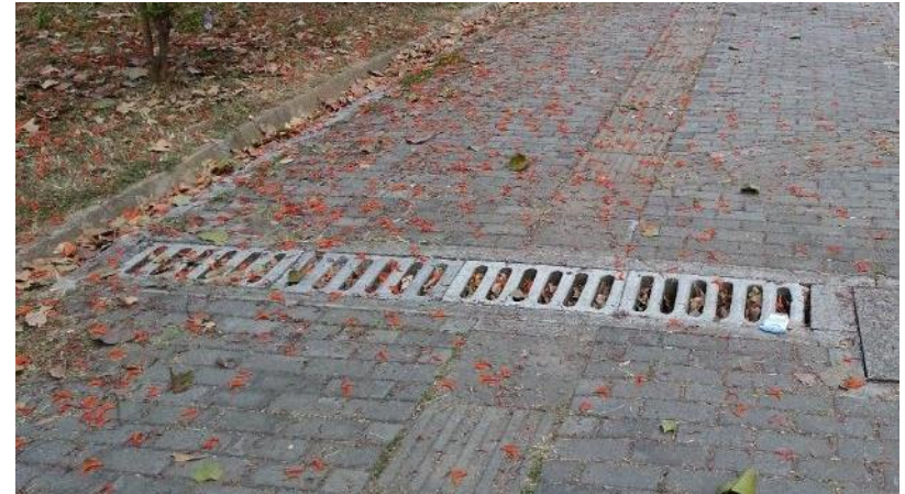
Desagüe piso. Hecho en concreto con estructura de varilla de hierro, se encuentra en una pequeña pendiente que permite el alto flujo de agua.
