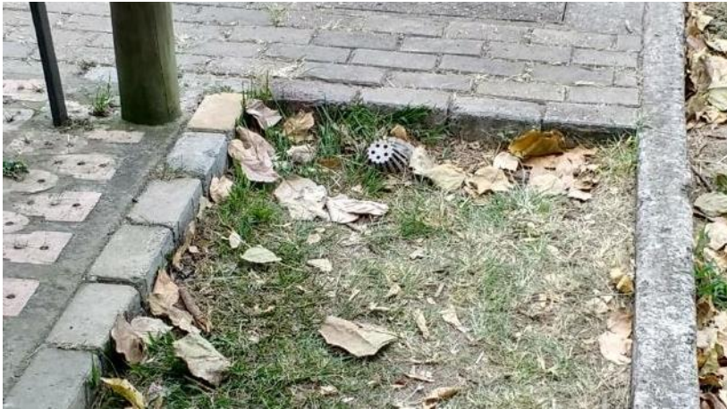
Desagüe tipo sifón. Hecho de acero, evita la entrada de partículas gruesas, permite la evacuación del agua. Ubicado en una jardinera detrás de una pérgola.
