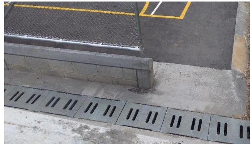
Desagüe plástico. Esta hecho en polímeros reciclados, son livianos. Está ubicado al lado de la placa polideportiva.
