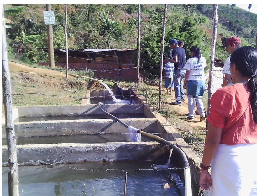
Imagen 5: Tanques de agua, sector 6 (Caro, 2014).
