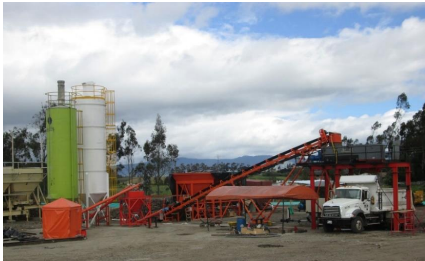
Figura 20. Dosificación de Cemento a la Planta - Silos Fuente: SONACOL S.A.S. 2015
