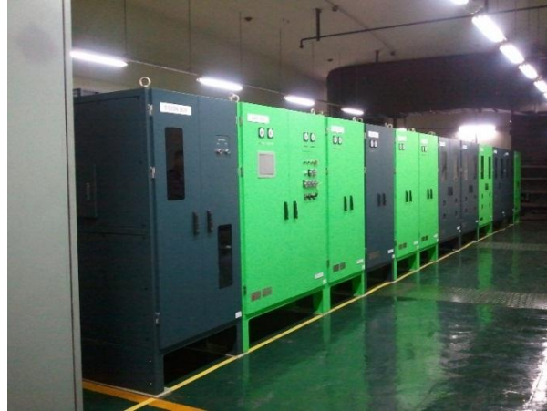
Figura 29. Sistema de almacenamiento del metro de Seúl. Tomado de: http://www.energystorageexchange.org/projects/1587
