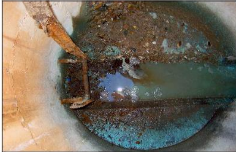
Corrosión en un colector
