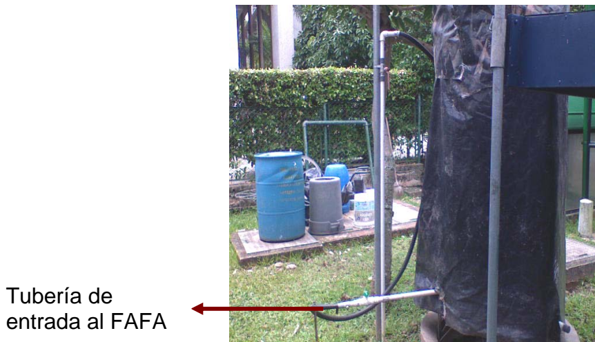
Figura 11. Tubería de entrada
