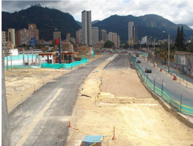
Figura 1. Estado de la Carrera 26 en Bogotá
