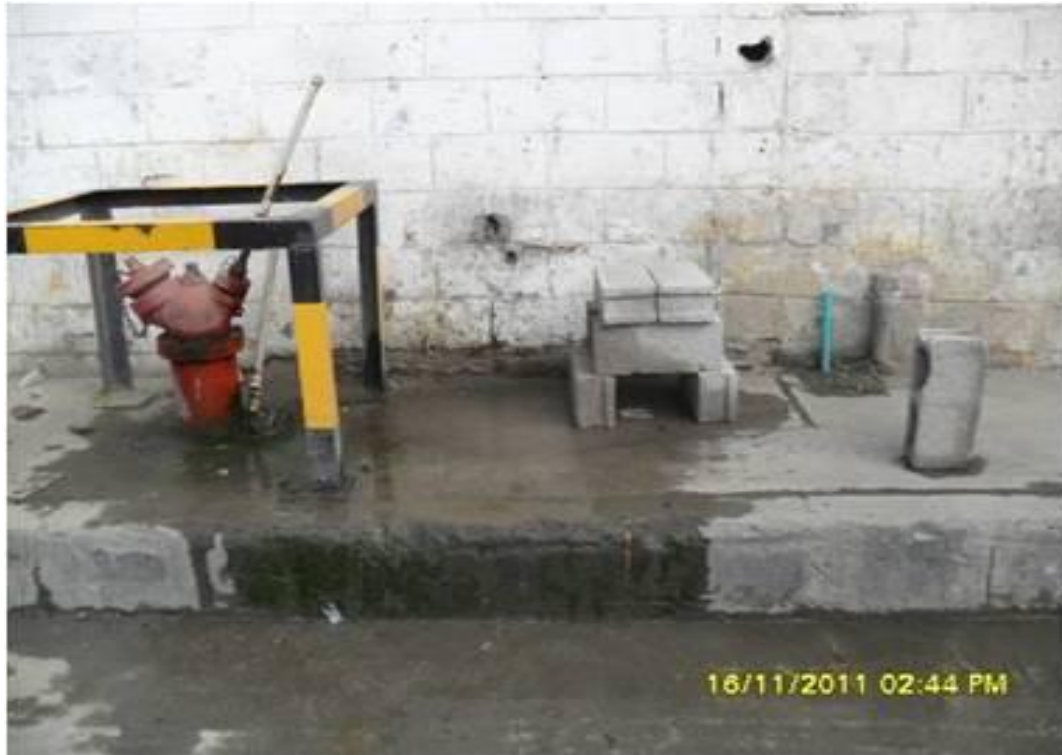
Fotografía 17. Fuga en hidrante
