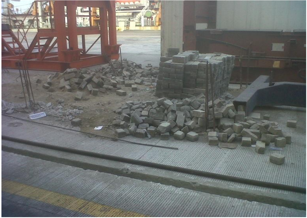
Fotografía 39. Inadecuado almacenamiento de materiales de construcción
