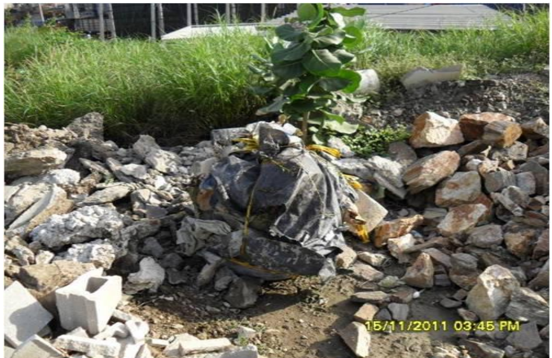
Fotografía 22. Acumulación residuos de obra
