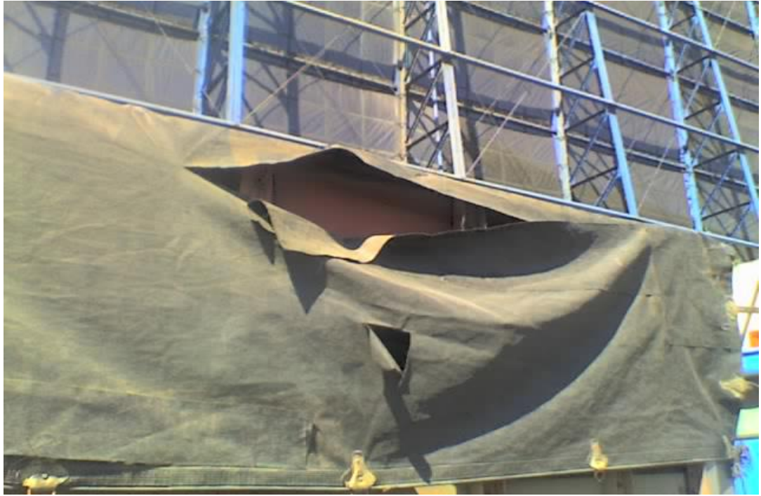
Fotografía 3. Carpa en mal estado
