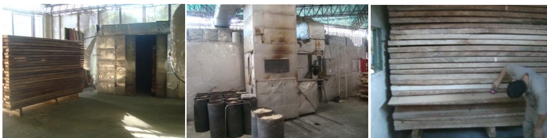
Fotografía 8. Cámaras de secado de madera.
