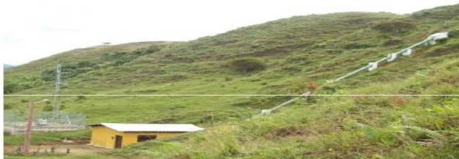
Panorámica de la Micro Central, incluye tubería de carga, Casa de Máquinas y Subestación Elevadora tipo patio. Diciembre 2007
