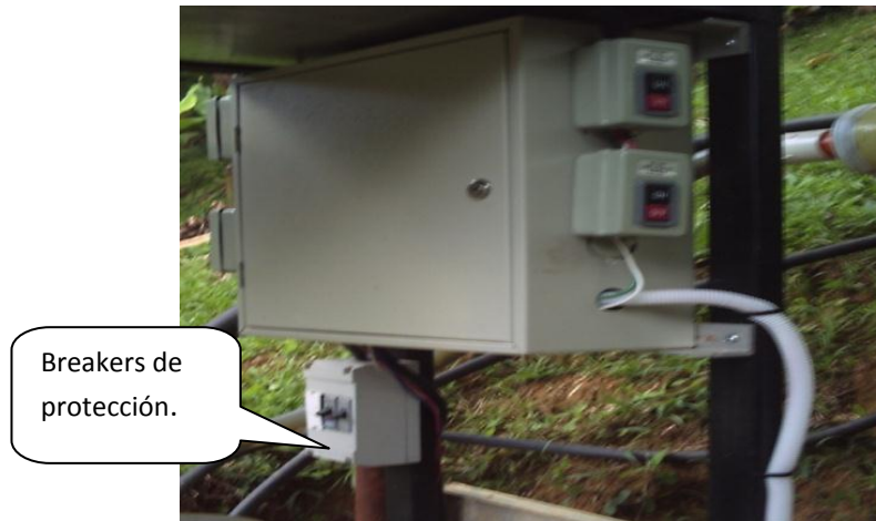
Figura 44. Breakers de Protección.
