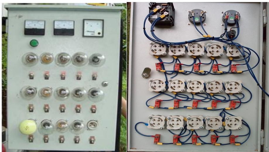
Figura 36. Tablero de carga.
