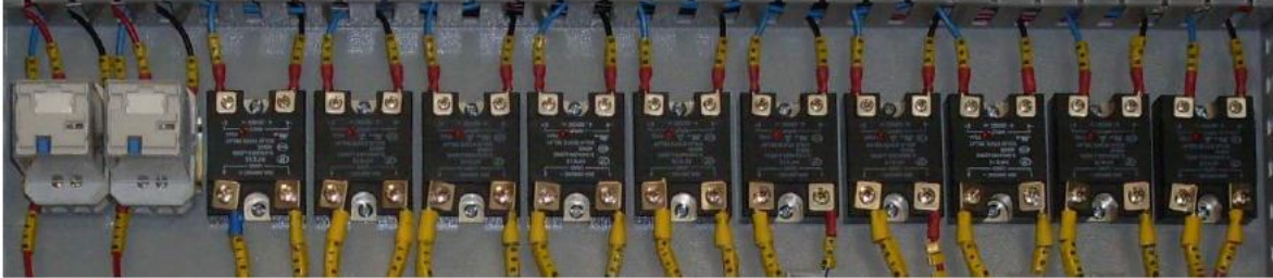
Figura 18: Sistema de Acondicionamiento de Relés [16]
