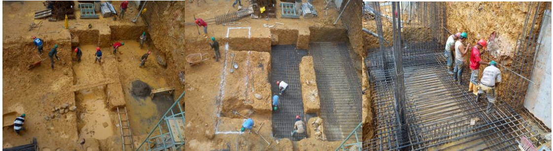
Figura 23 Excavación zapata eje 4 y armado de zapata ejes 1-2 y vigas de amarre por los ejes B y C
