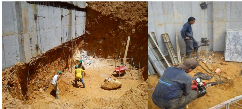
Figura 12 Tensionado de anclajes sótano MCONT -3 sótano -2 entre ejes (1-9) y eje A, perfilado y replanteo del terreno costado sur del terreno
