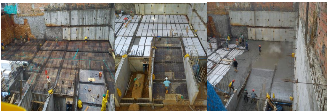
Figura 41 Armado y fundida placa 2 s-3 y rampa 1 entre muros M4 Y M5
