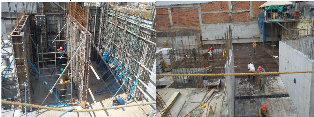
Figura 49 Fundida Muros sótano -1 M19, M20, M21 M22 y armado placa cubierta 2 sótano -2 con rampa.
