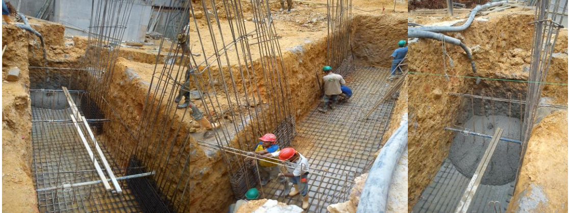
Figura 28 Armado y fundido zapata foso del ascensor, muro M1 y arranque muros M11, M13, M15, M17.
