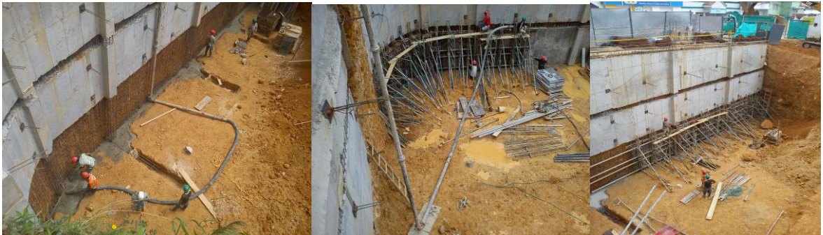
Figura 17 Encofrado apuntalado y fundida del muro de contención MCONT -3, zapatas y viga de amarre ubicadas en el eje A costado sur del terreno.
