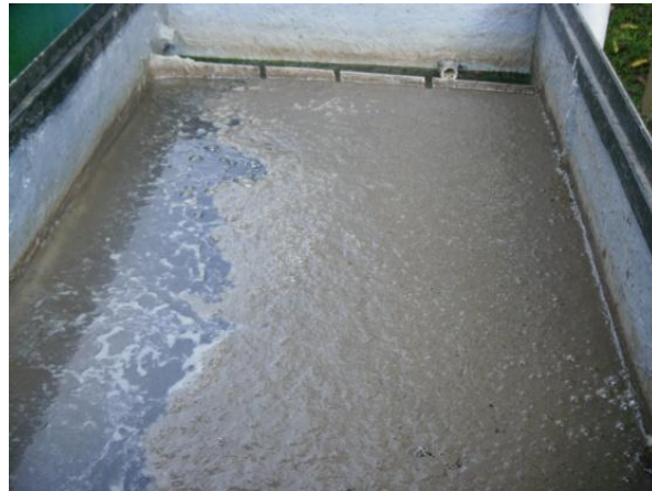
Figura 16. Lodo acumulado en la superficie del Sedimentador.
