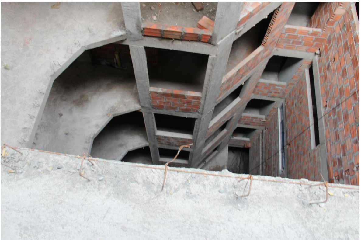
Ilustración 13. Estructura sin barandas de protección
