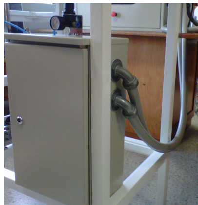
Figura 42: Tubería flexi conduit implementada en el prototipo 2. Fuente autor
