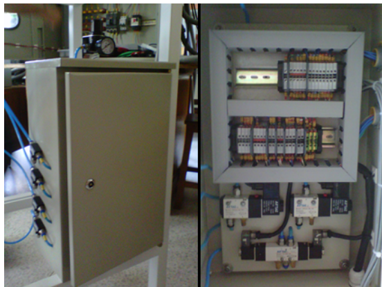
Figura 45: Gabinete de paso del prototipo 2. Fuente autor
