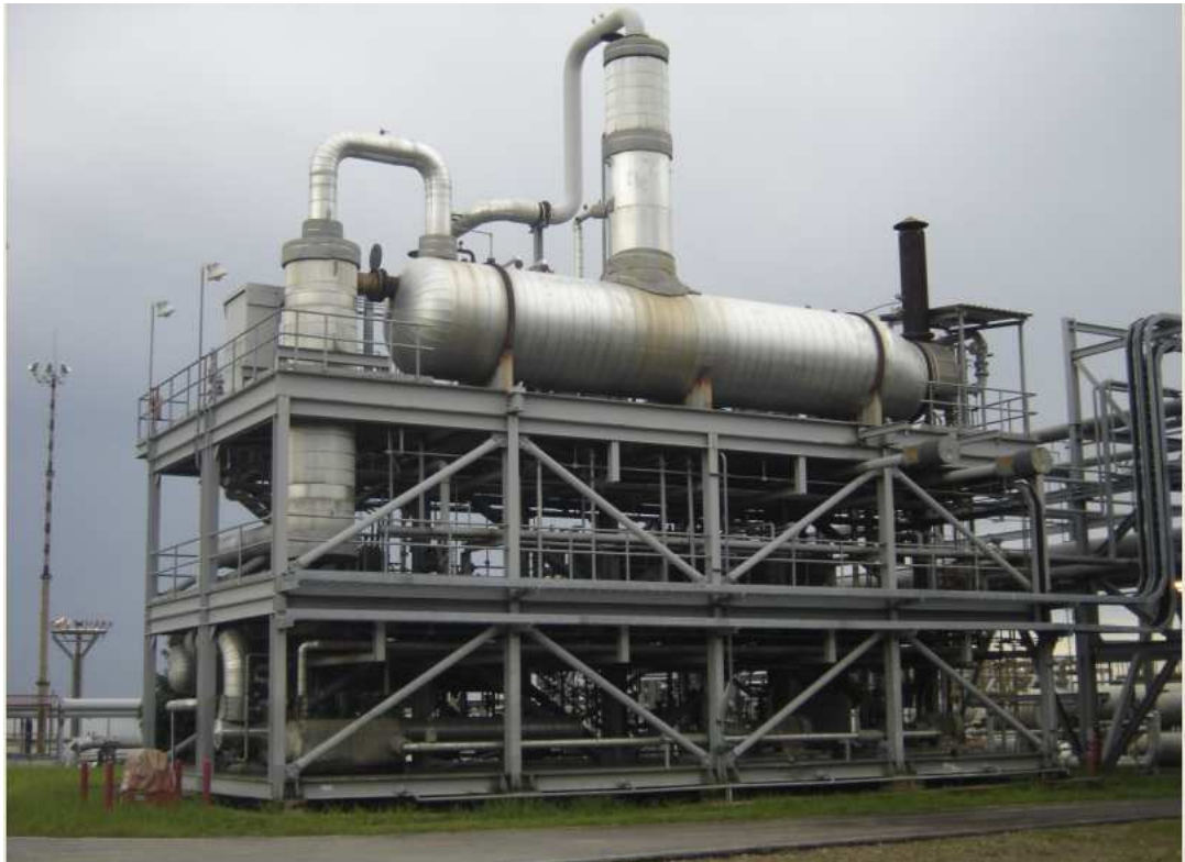
Figura 3. Unidad Regeneradora de glicol (3)
