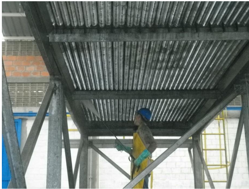
Ilustración 7: Fotografía lavado aerocondensador
