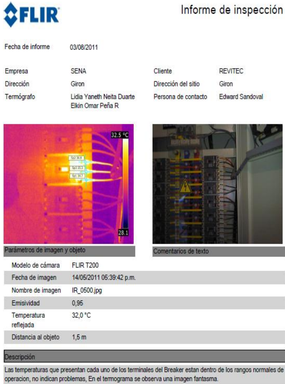
Figura 42. Reporte inspección termográfica realizado con el software FLIR Quick Report
