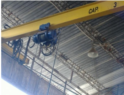
Fig. 30 Polipasto Marca NIPPON Defectuoso
