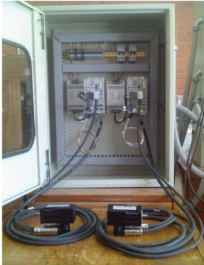
Figura 37. Gabinete del Sistema de Control de Movimiento Implementado. [28]
