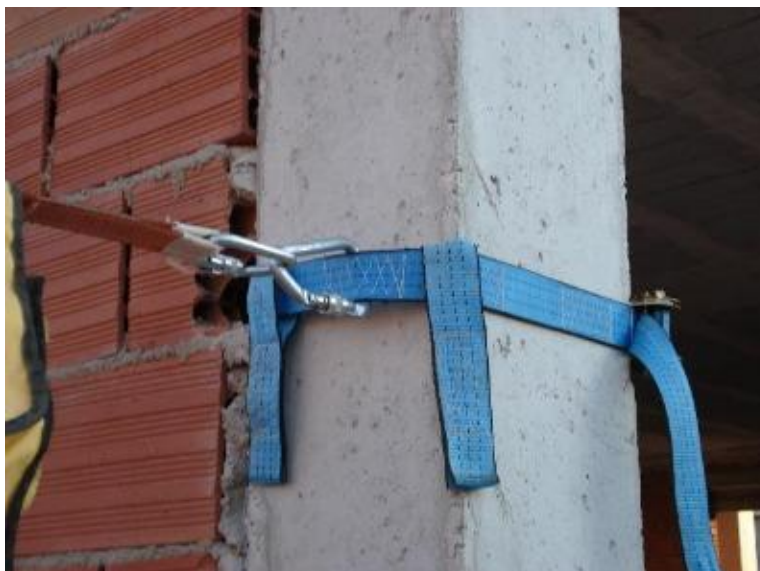
Figura 6: Elemento estructural utilizado como anclaje.
