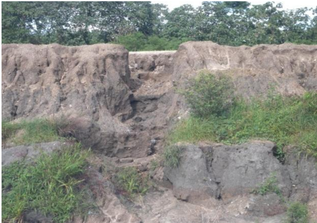
Foto 20. Erosión en berma Sur
