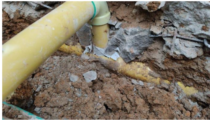
Imagen 10. Indebida conexión de tuberías
