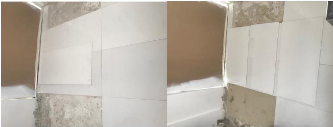
Imagen 2. Diferencia tonos de enchape para piso
