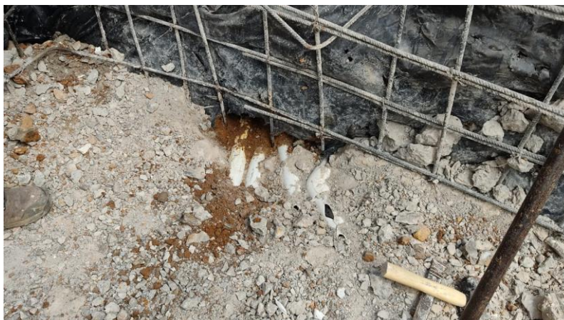
Imagen 11. Zona de filtración de agua en la piscina
