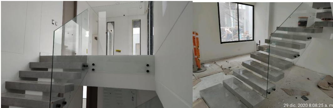
Imagen 44. Vidrios de pasamanos de escaleras
