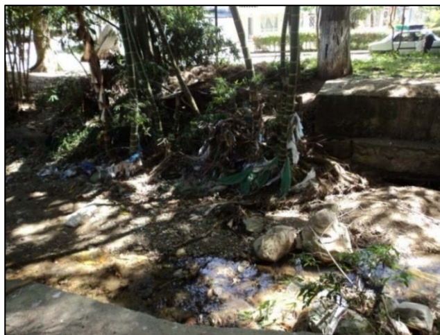
Foto 11. Punto crítico quebrada vía Guatiguara
