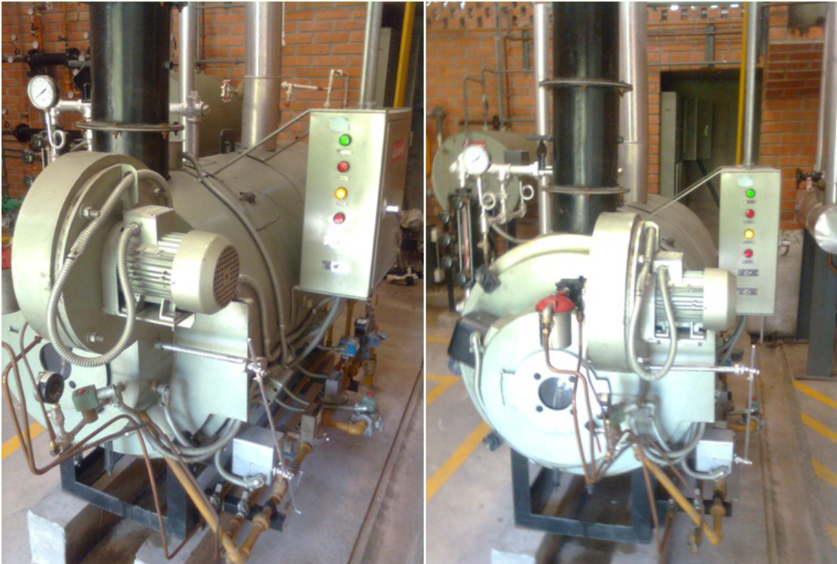
Figura 1: Caldera del laboratorio de Ingeniería Mecánica de la UPB
