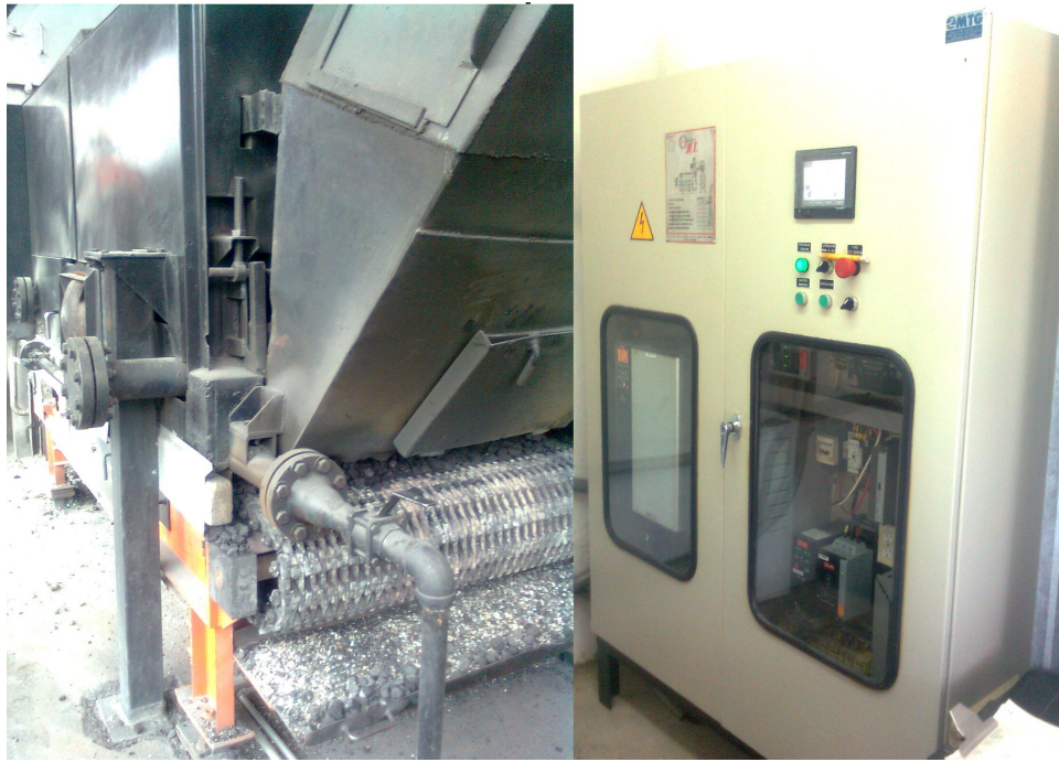
Figura 21: Caldera y Tablero de Control Harinagro S.A.
