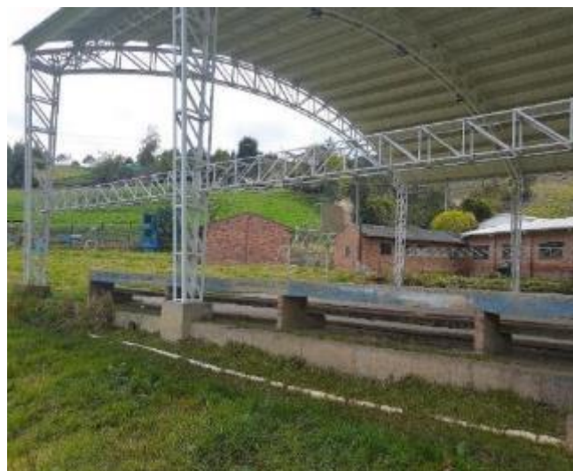
Ilustración 18. Estado preliminar y evaluación de la zona deportiva (Coliseo).
