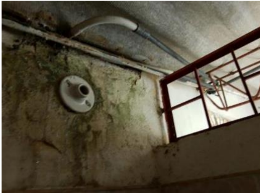
Ilustración 21. Visualización de elementos eléctricos de las aulas y afectaciones por humedad.
