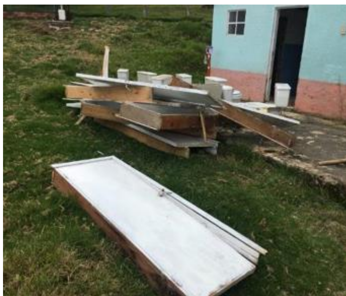
Ilustración 32. Elementos desmontados de los baños y ubicados fuera del área de trabajo.
