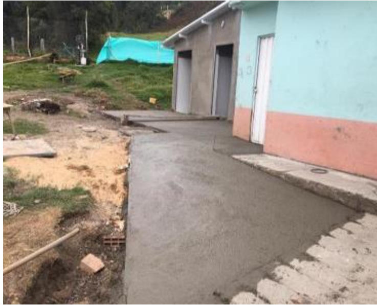
Ilustración 72. Fundida y terminación de andenes principales ubicados en la parte externa de las baterías sanitarias.
