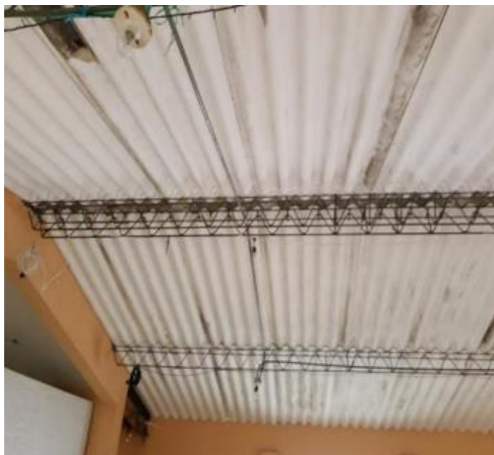
Ilustración 23. Estado de los elementos metálicos de soporte de la cubierta.
