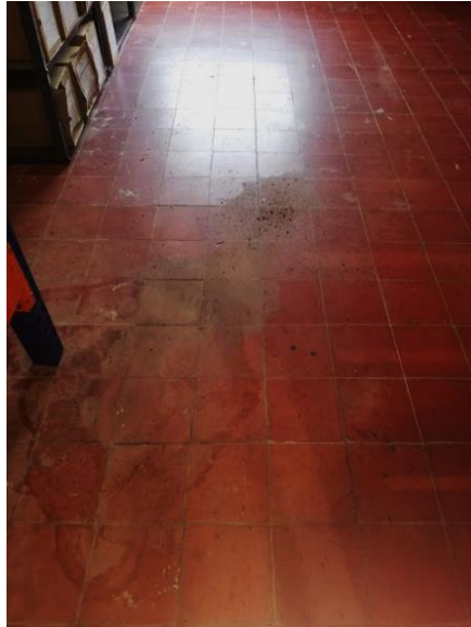
Imagen 67 - Rastros de empozamiento de aguas en el piso del almacenamiento en el Archivo General Quinta Brigada
