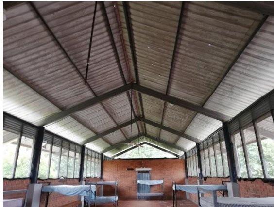
Imagen 91 - Cubierta de los alojamientos BITER 5 Fuente: Sección técnica - Batallón de Ingenieros N°5 CR Francisco José de Caldas
