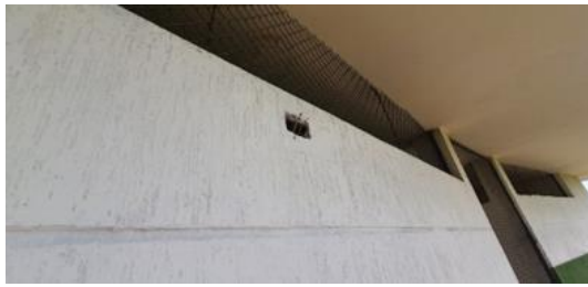
Imagen 48 - Puntos eléctricos rancho tropas BITER 5
