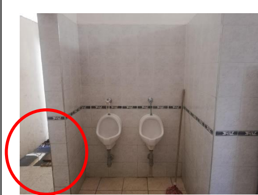
Imagen 17 - Orinales Bateria Sanitaria bloque de oficinas y alojamientos – Batallón de Ingenieros N°5
