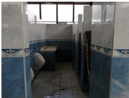
Imagen 87 - Sanitarios y orinales BITER 5 Fuente: Sección técnica - Batallón de Ingenieros N°5 CR Francisco José de Caldas
