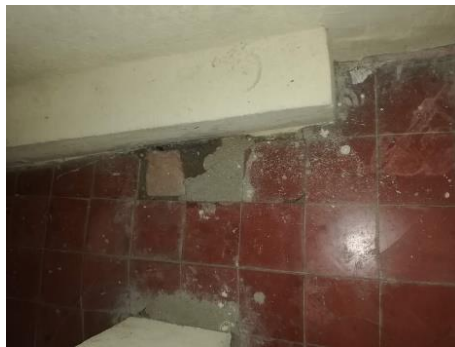
Imagen 68 - Desprendimiento del enchape Archivo General Quinta Brigada
