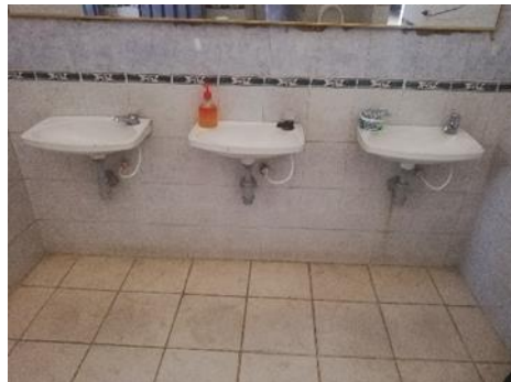
Imagen 15 - Batería de baños en el bloque de oficinas y alojamientos - Batallón de Ingenieros N°5 Fuente: Sección técnica - Batallón de Ingenieros N°5 CR Francisco José de Caldas
