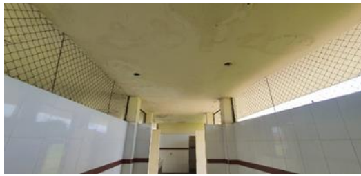
Imagen 51 - Humedad en placa rancho de tropas BITER 5 Fuente: Sección técnica - Batallón de Ingenieros N°5 CR Francisco José de Caldas
