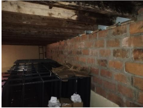
Imagen 65 - Mampostería sin pañete, estuco y pintura - Archivo General Quinta Brigada Fuente: Sección técnica - Batallón de Ingenieros N°5 CR Francisco José de
