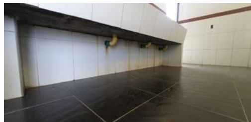
Imagen 47 - Conexiones sanitarias lavaplatos rancho de tropas BITER 5 Fuente: Sección técnica - Batallón de Ingenieros N°5 CR Francisco José de Caldas
