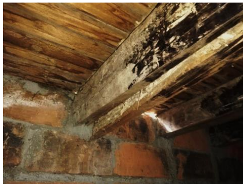
Imagen 64 - Estructura de madera con fallas estructurales Archivo General Quinta Brigada Fuente: Sección técnica - Batallón de Ingenieros N°5 CR Francisco José de
