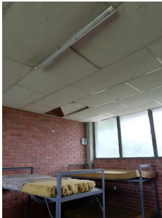
Imagen 89 - Cielo raso dormitorio Sub-Oficiales BITER 5 Fuente: Sección técnica - Batallón de Ingenieros N°5 CR Francisco José de Caldas
