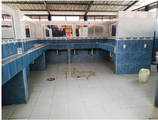
Imagen 85 - Lavamanos Batería sanitaria BITER 5 Fuente: Sección técnica - Batallón de Ingenieros N°5 CR Francisco José de Caldas
