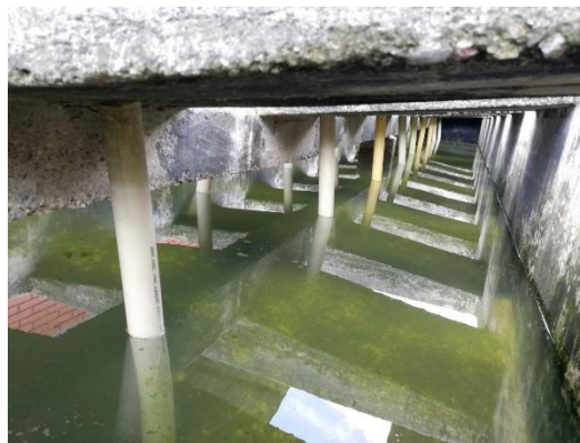
Imagen 81 - Pileta lavaderos BITER 5 Fuente: Sección técnica - Batallón de Ingenieros N°5 CR Francisco José de Caldas
