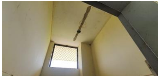
Imagen 50 - Salidas luminarias rancho de tropas BITER 5
