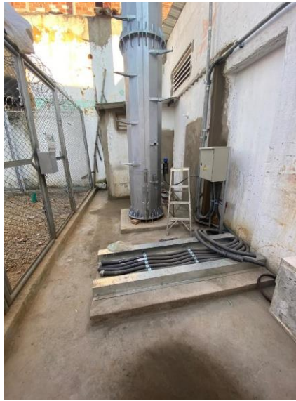
Figura 19. Placa para equipos y Tablero General de Distribución. Fuente: (Mankco S.A.S., 2021)
