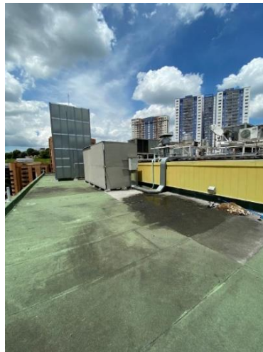
Figura 20. Estructuras existentes en estación CUBC El Bosque. Fuente: (Mankco S.A.S., 2021)
