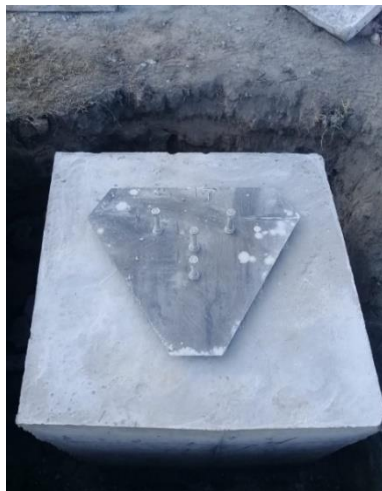
Figura 12. Base central para torre, Gamarra, Cesar. Fuente: (Mankco S.A.S., 2021)
