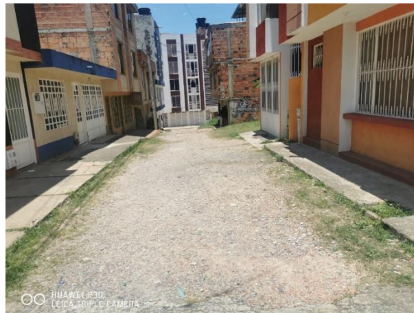
Ilustración 43. Estado actual de los tramos N°4
