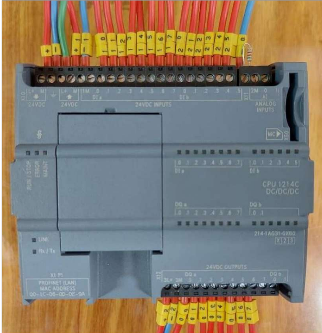
Figura 72. Conexión de los cables en las salidas y entradas del PLC. Fuente: propia.
