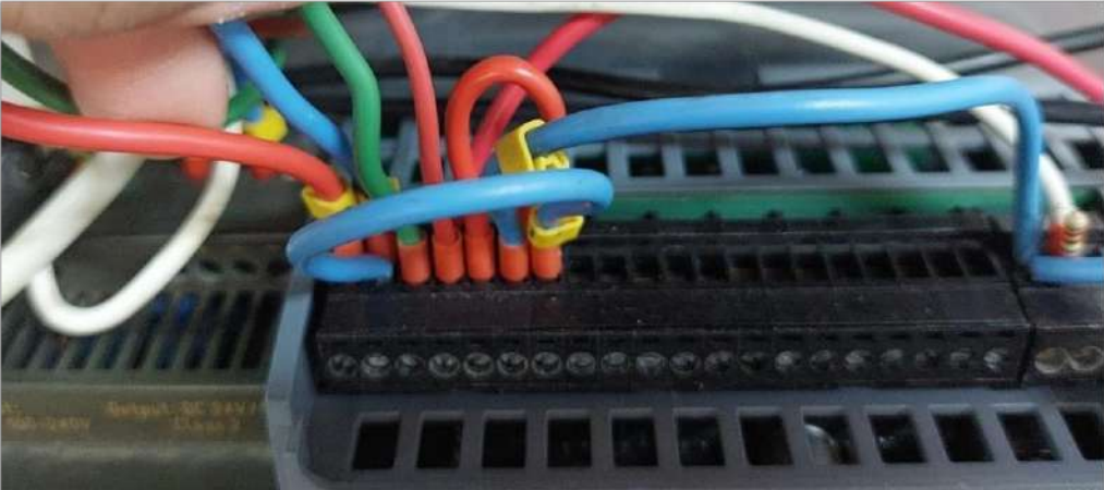
Figura 67. Conexiones del PLC en físico. Fuente: propia
