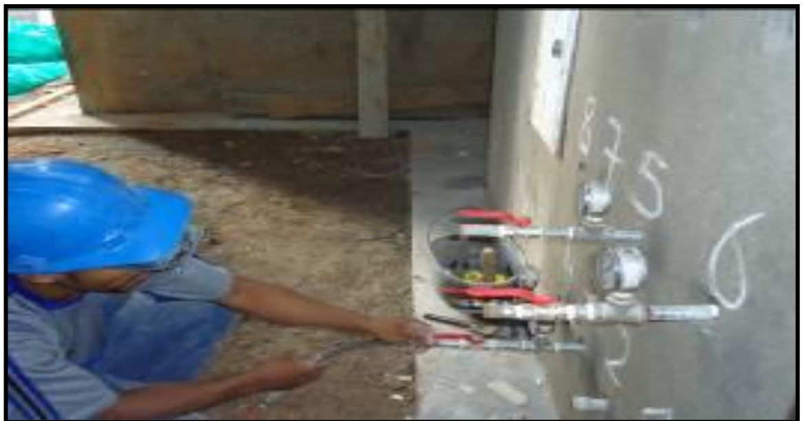
EN ESTA IMAGEN, SE ESTABAN CARGANDO LOS MANÓMETROS CON AIRE, HASTA LLEGAR A UNA PRESIÓN DE 40 PSI (POR NORMA ES 35 psi)
