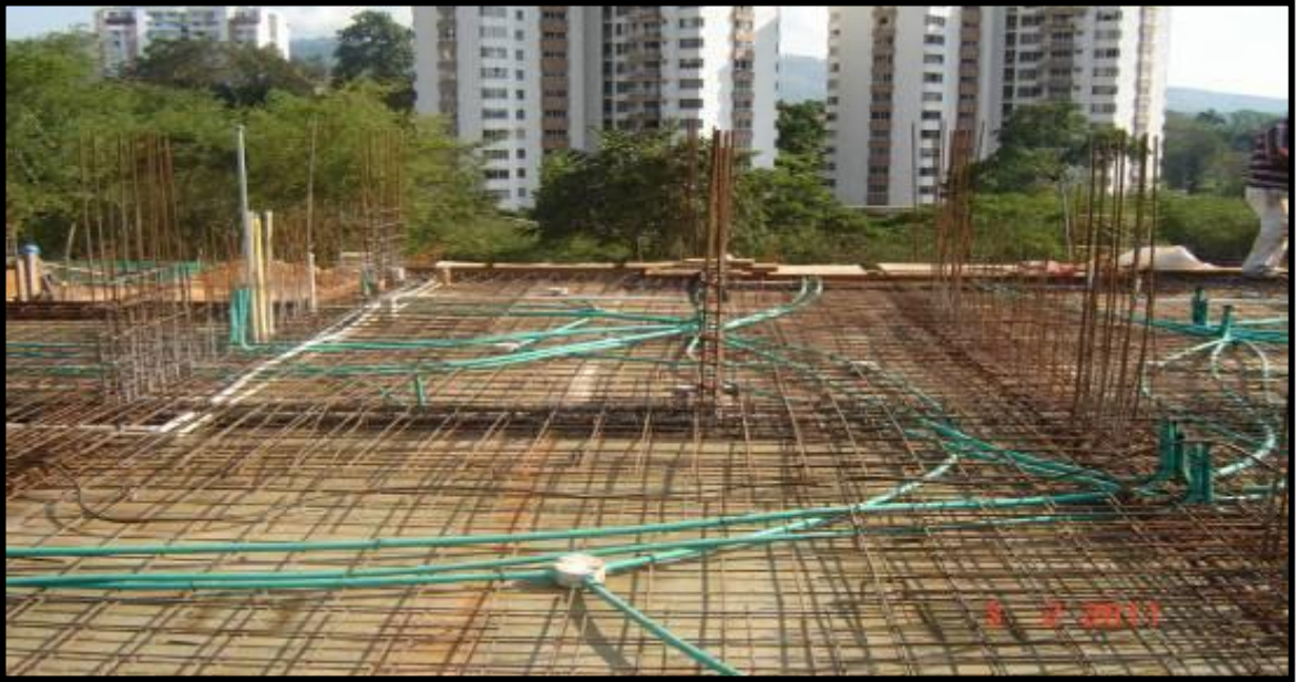
REVISIÓN DE LA TUBERÍA ELÉCTRICA Y SANITARIA ANTES DE FUNDIR, PLACA DE PISO 2
