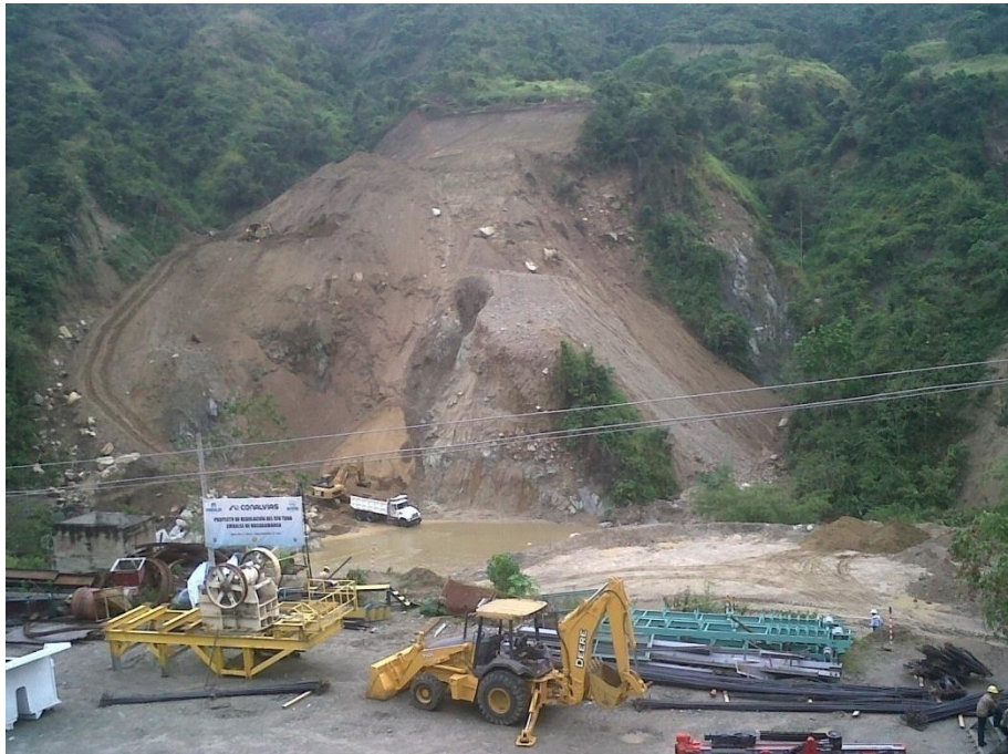
Adecuación de la zona donde se construirá el túnel de desviación del río
