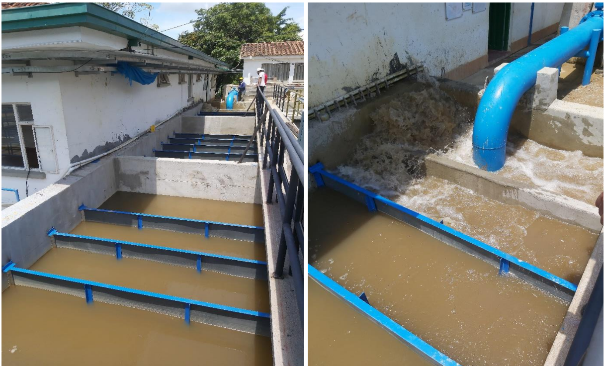
Figura 6. Floculadores Planta de Tratamiento de Agua Potable La Colina
