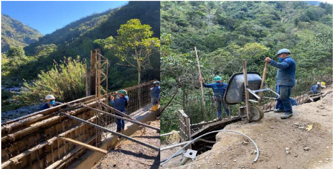
Figura 33. Armado de acero y vaciado de concreto para zarpa y vástago del muro en voladizo
