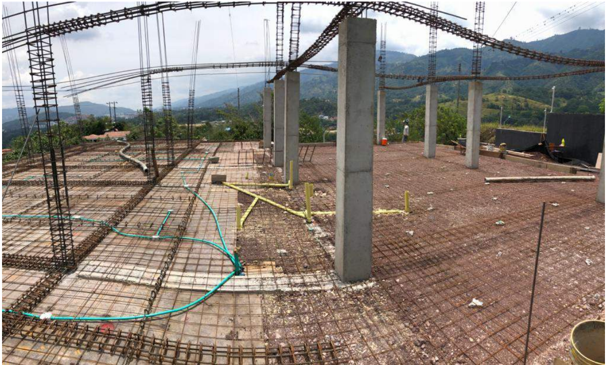
Figura 15. Tubería eléctrica y sanitaria.
