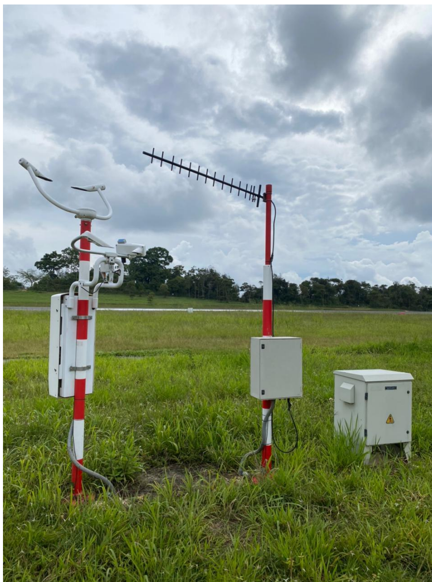
Ilustración 75. Estación meteorológica a inicio de pista 75
