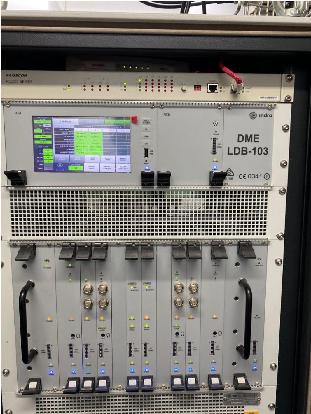
Ilustración 74. Sistema de control DME mesa de Los Santos, aeropuerto de Palonegro 74
