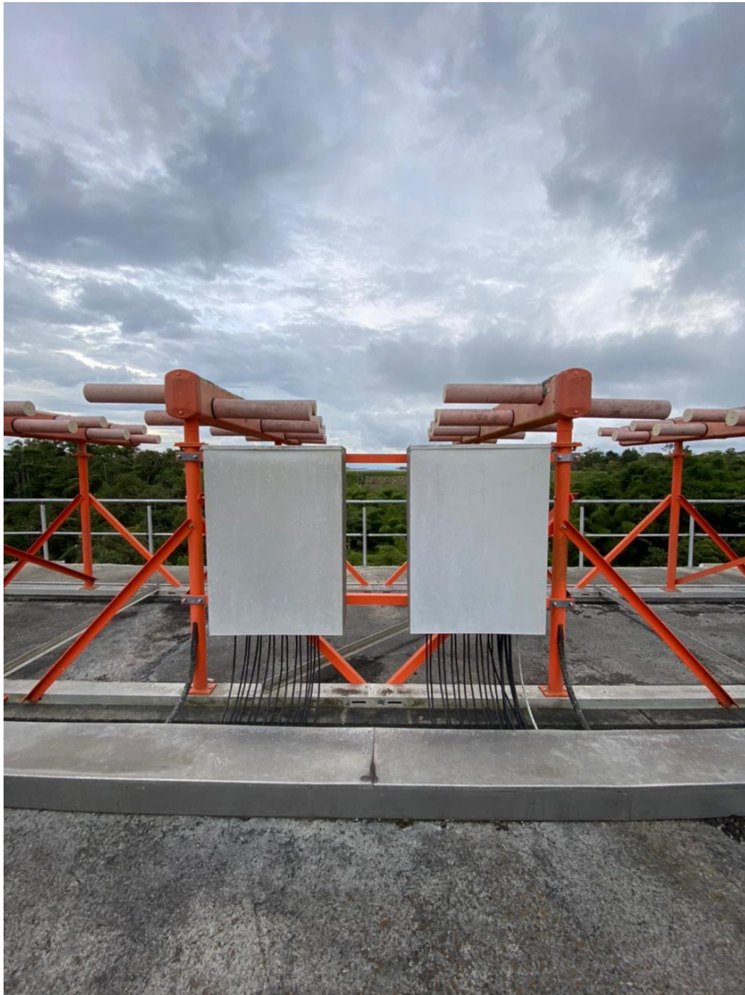
Ilustración 85. Arreglo antenas localizador ILS Palonegro 85
