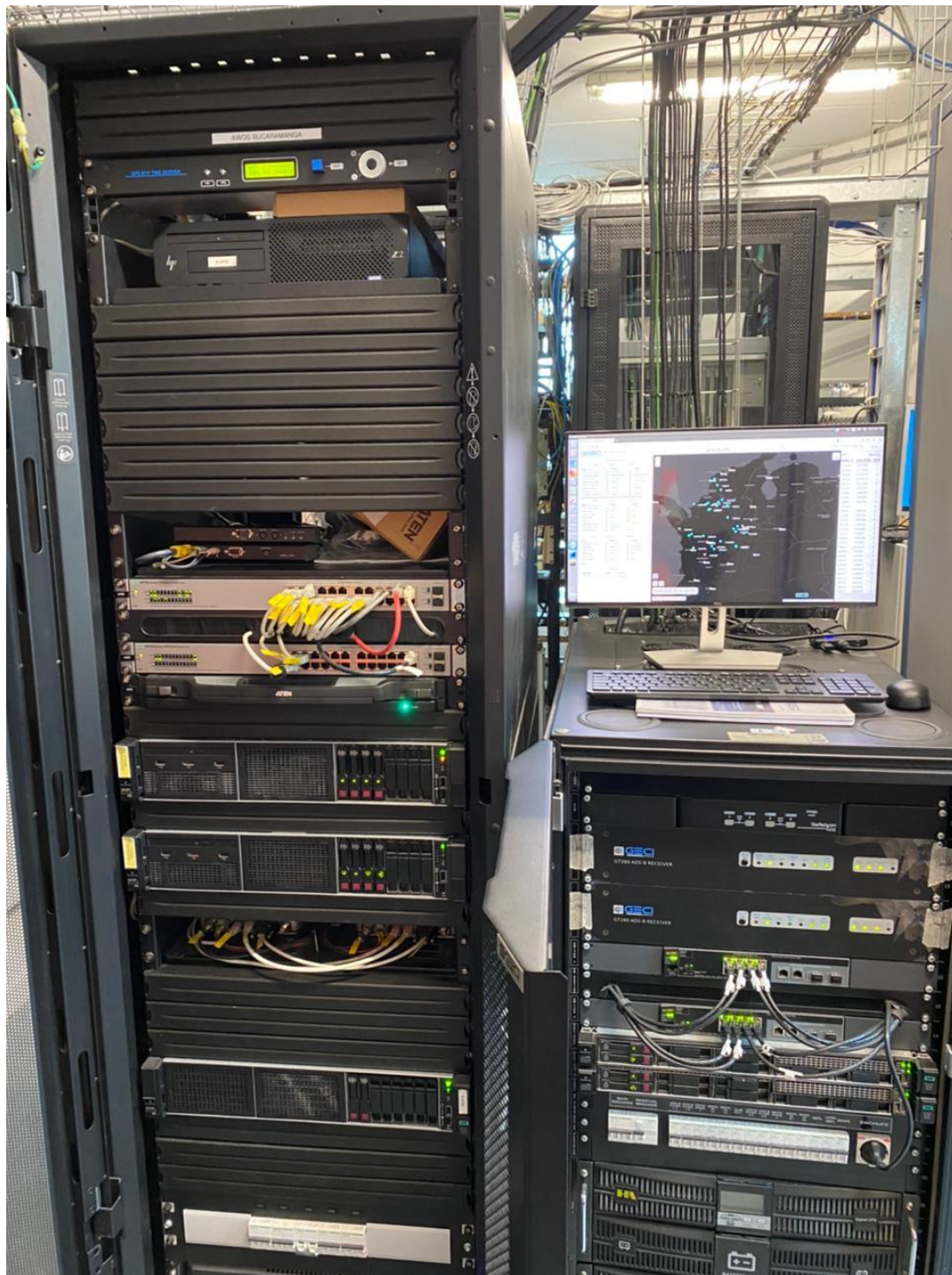
Ilustración 87. Sistema ADS-B aeropuerto de Palonegro, Bucaramanga 87
