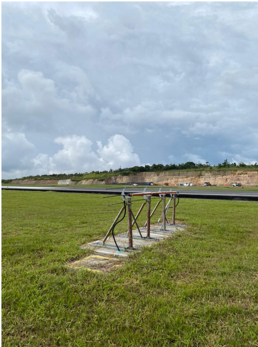
Ilustración 82. End-Fire Antenna System para el glideslope 82
