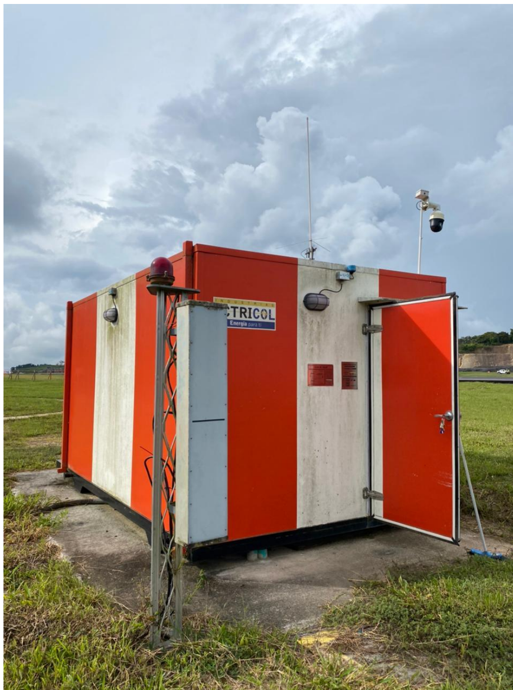
Ilustración 79. Puesto de control del ILS 79
