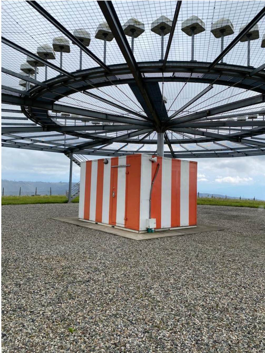
Ilustración 70. Centro de operación y mantenimiento D-VOR mesa de Los Santos, Aeropuerto de Palonegro 70
