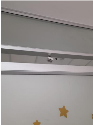
Figura XXIV. Colocación de sensores en el Área de Consulta Externa.
