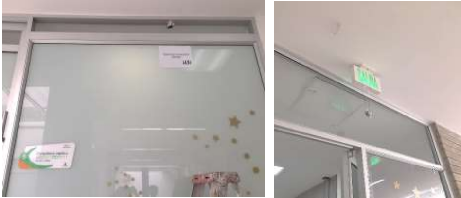
Figura 27 y 28. Fotografía montaje sensores.
