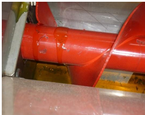
Ilustración 21. Escape de aceite en tubo soporte
