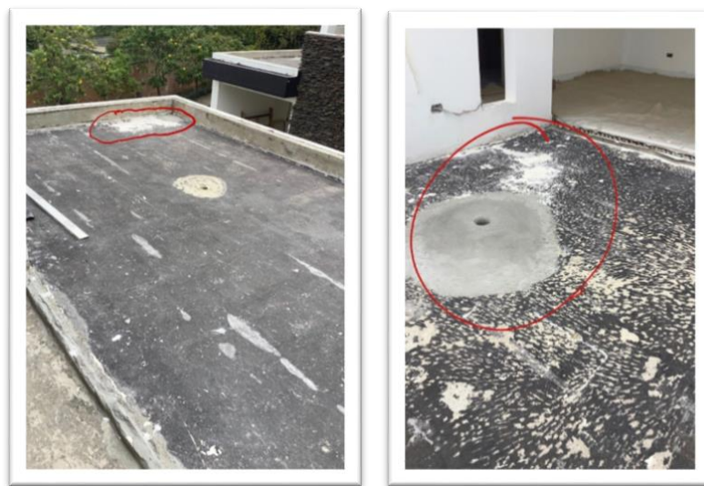
Figura No. 13. Humedad en terrazas
