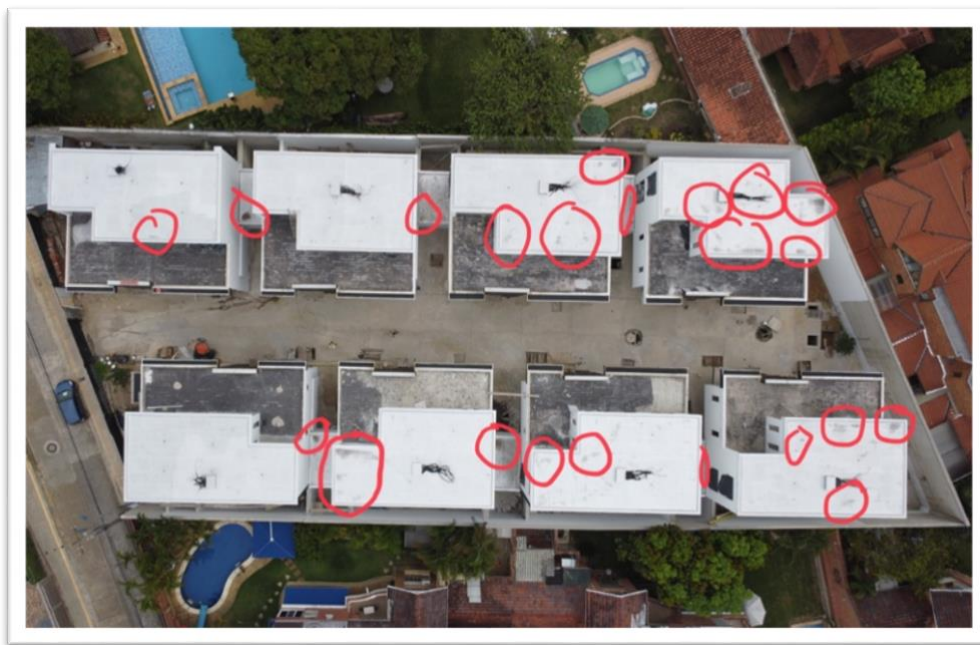
Figura No. 14. Humedad placas de cubiertas
