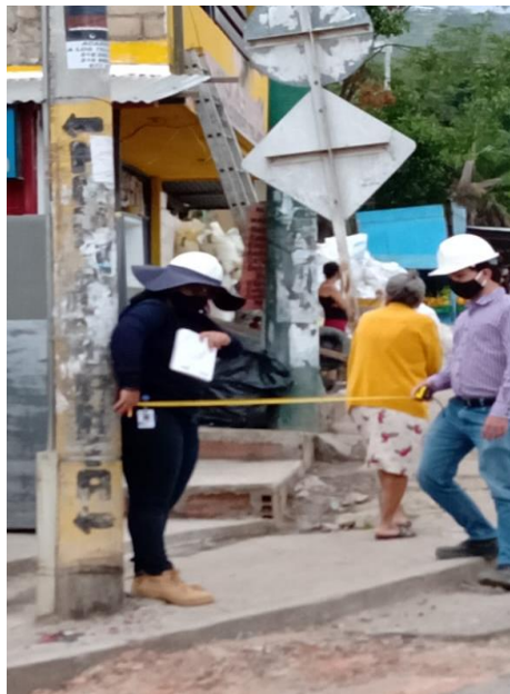
Figura 7. Medidas para ubicar los accesorios instalados.
