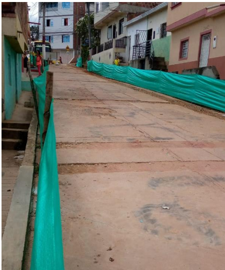
Figura 10. Pavimentación a reponer.
