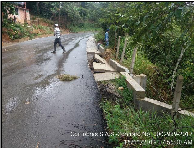
Perdida de la banca por desestabilización de talud.
