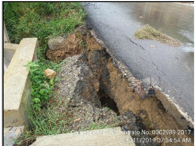
Desplazamiento de alcantarilla junto con su relleno por desestabilización de talud.
