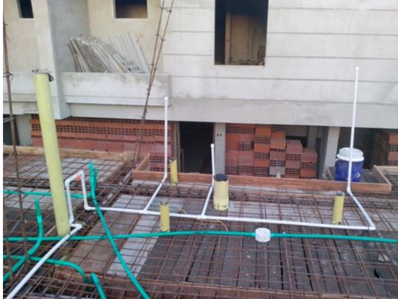
Ilustración 26. Tubería hidráulica y sanitaria para baño Fuente: Autor del proyecto
