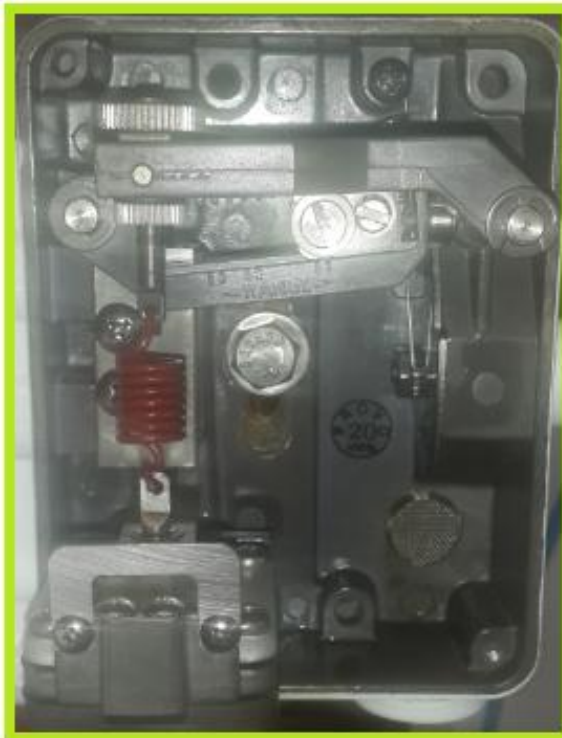
Figura 47. Del mantenimiento interno de la tapa del convertidor IP del ZERO y el SPAM. [Fuente: autor]
